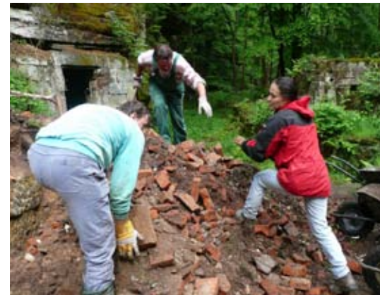
In Aktion: Ehrenamtliche Arbeiter beseitigen Trümmer im Areal der Grundmühle (Dolský mlýn). Nicht nur, dass das Erscheinungsbild des Denkmals im Nationalpark ansehnlicher wird, es verschwindet auch eine Menge an Material, welches ursprünglich nicht hierher gehörte. Foto: Natalie Belisová
